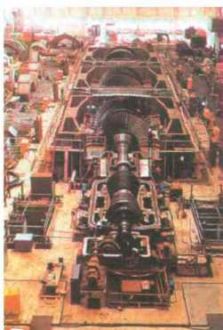
Ατμοστρόβιλος σε εργοστάσιο παραγωγής ηλεκτρικής ενέργειας.
